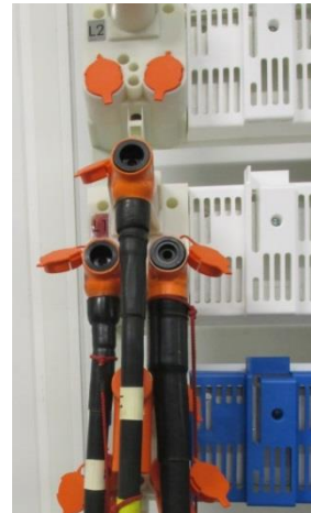
Prises de réalimentation TIPI 8-1800 pour la Phase 1
